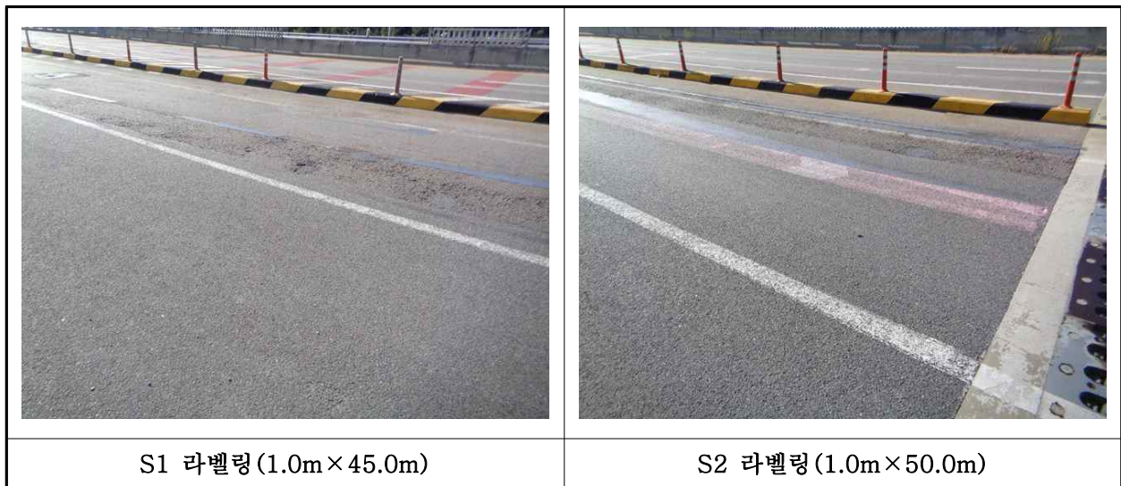
【사진 1.3.20】 교면포장 손상현황
